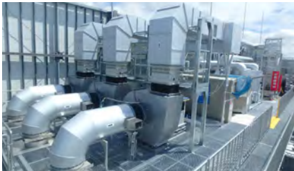
VOCガス処理装置
