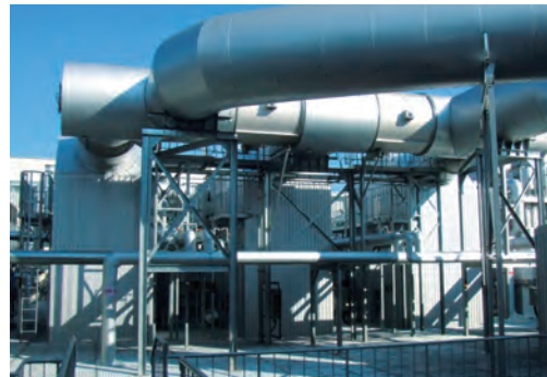
VOCガス処理装置
