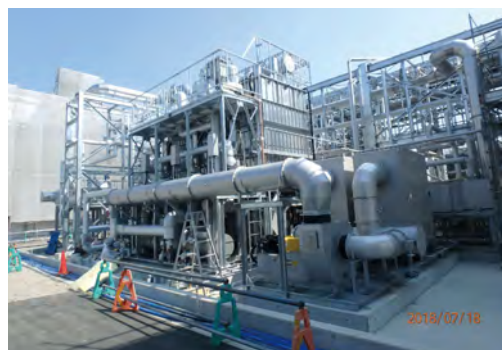
VOCガス処理装置
